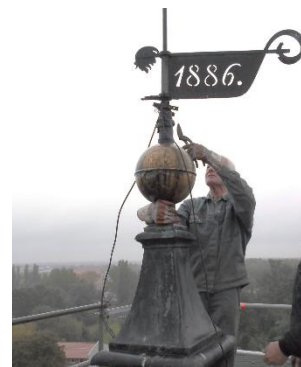
Reste der alten absturzgefährdeten Turmbekrönung
