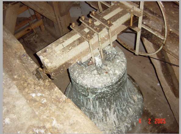
Durch Vogelkot verschmutzte Anlage
